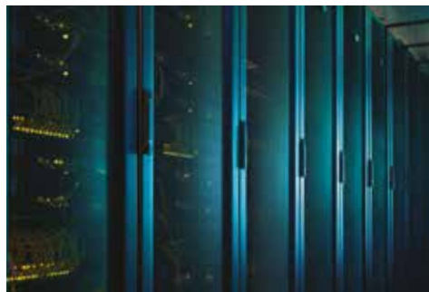
Auf der Data Centre World Frankfurt im Mai teilte Piller mit, mit seiner Batterie-USV der M+ Serie in den Bereich der Hyperscale-Rechenzentren zurückzukehren
