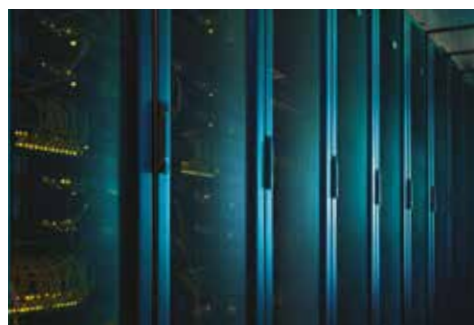
5月，在法兰克福数据中心世界展上，Piller凭借其M+系列电池式不间断电源 (UPS) 重返超大规模数据中心领域。
